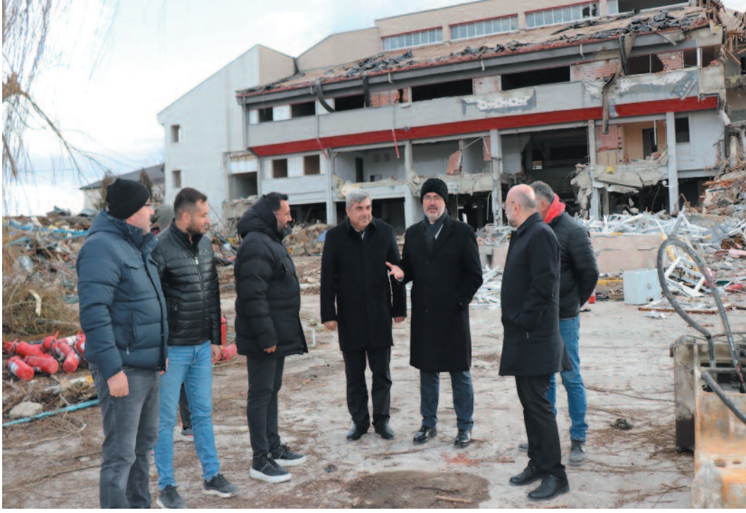
Fen Lisesi inşaatında incelemelerde bulunan AK Parti Afyonkarahisar Milletvekili Av. Ali Özkaya, İl Başkanı Av. Turgay Şahin, İl Millî Eğitim Müdürü Miraç Sünnetçi; teknik ekip ve yetkililerden inşaatın durumu hakkında bilgi aldılar
